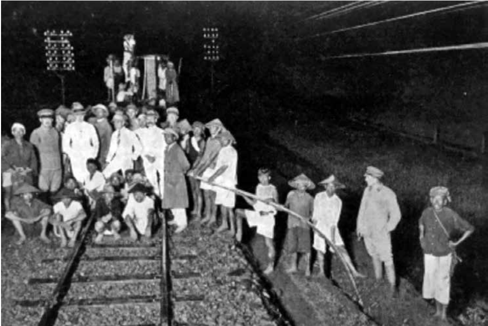
Nachtelijke kabellegging tusschen Bandoeng en radioontvangststation te Rantja-Ekek, uit: Jaarverslag Indische Post, 1929.
