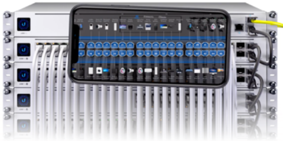
Figuur 11 AR applicatie van Ubiquiti waarbij de gebruiker kan zien welke apparaten met welke poorten verbonden zijn. Bron: Ubiquiti
