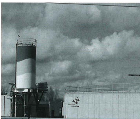
Een waterzuiveringsinstallatie van het waterschap 'Rivierenland'.
