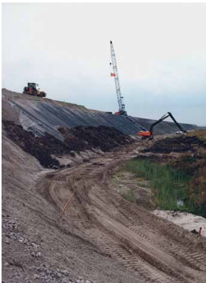
FIGUUR 1: AEC-BODEMAS WERD TOT VOOR KORT ALLEEN GEBRUIKT ALS IBC-BOUWSTOF, ZOALS IN DEZE GELUIDSWAL BIJ VLEUTEN, DIE IS VOORZIEN VAN EEN FOLIE ALS AFDICHTING.
