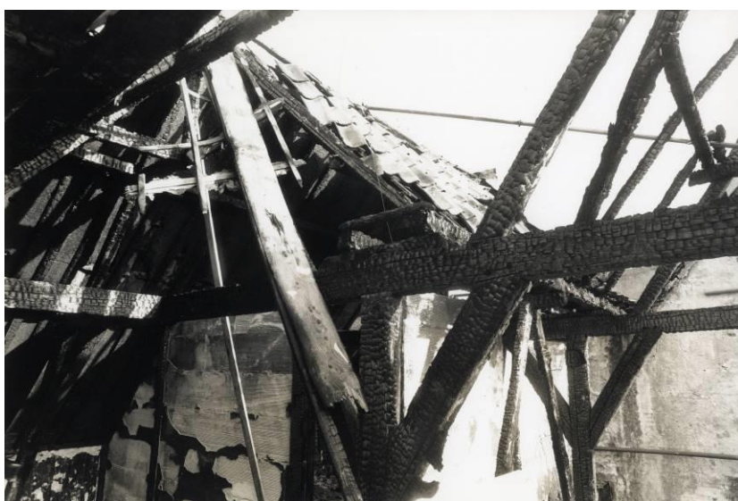
Overzicht spantconstructie na brand
