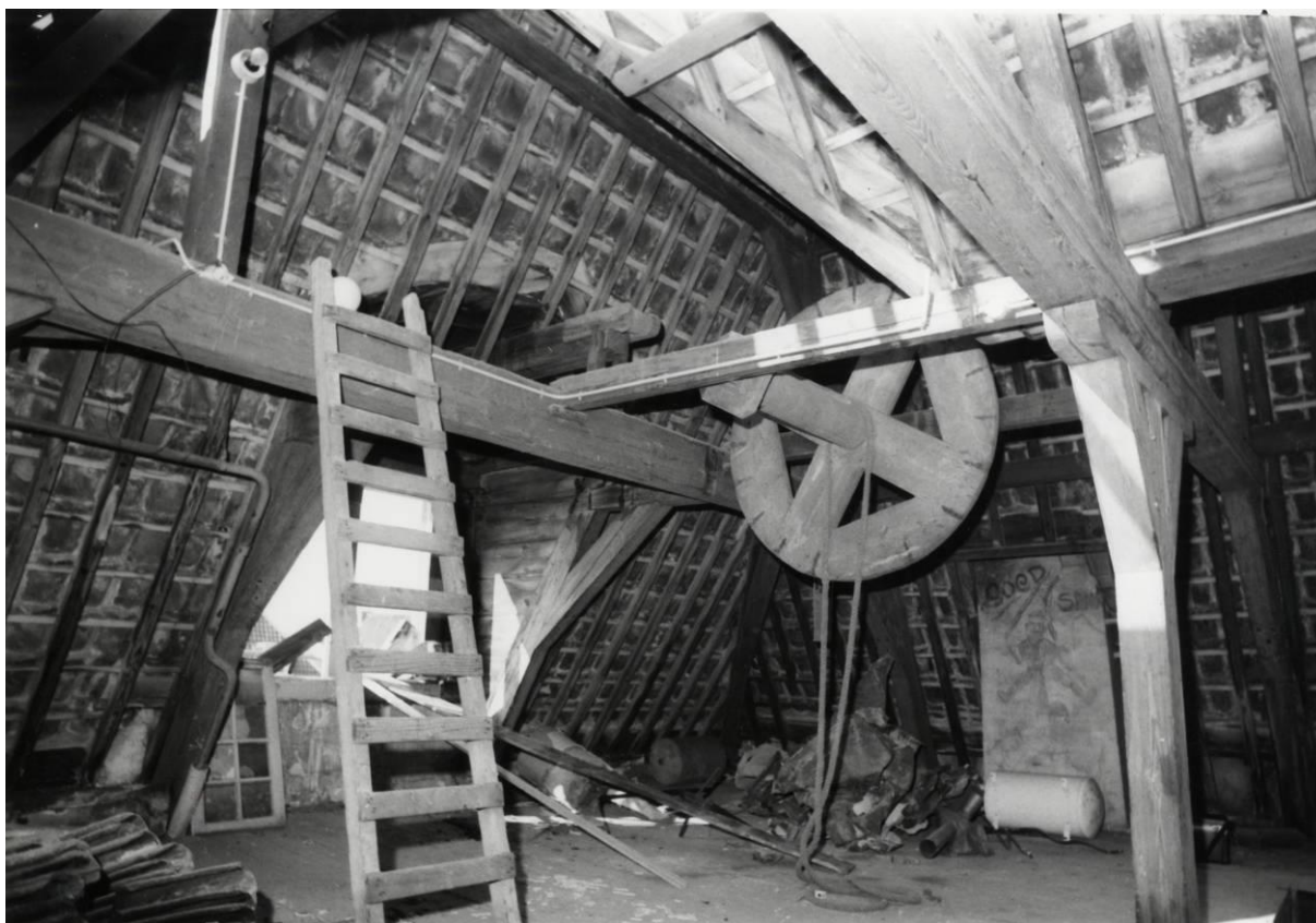
Overzicht spantconstructie met variant met makelaar
