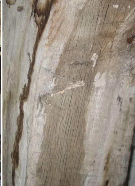
Gekromd spantbeen met zaagspoor
