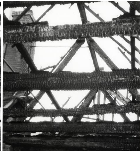
Overzicht spantconstructie na brand
