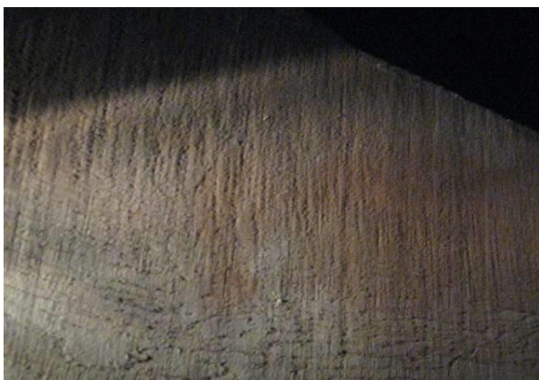
Zaagsporen op dekbalk
