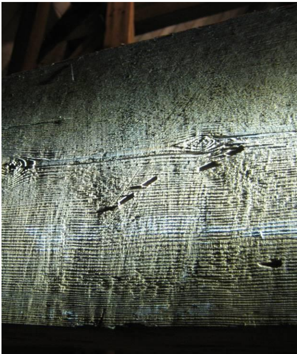
Zaagsporen op constructievlak dakbalk
