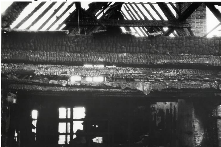
Overzicht spantconstructie na brand
