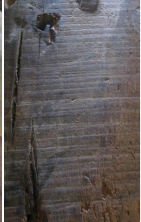
Zaagsporen binnenzijde spantbeen
