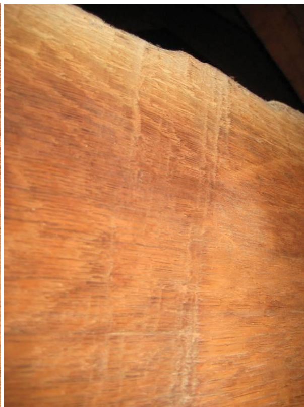
Zaagsporen op dekbalk
