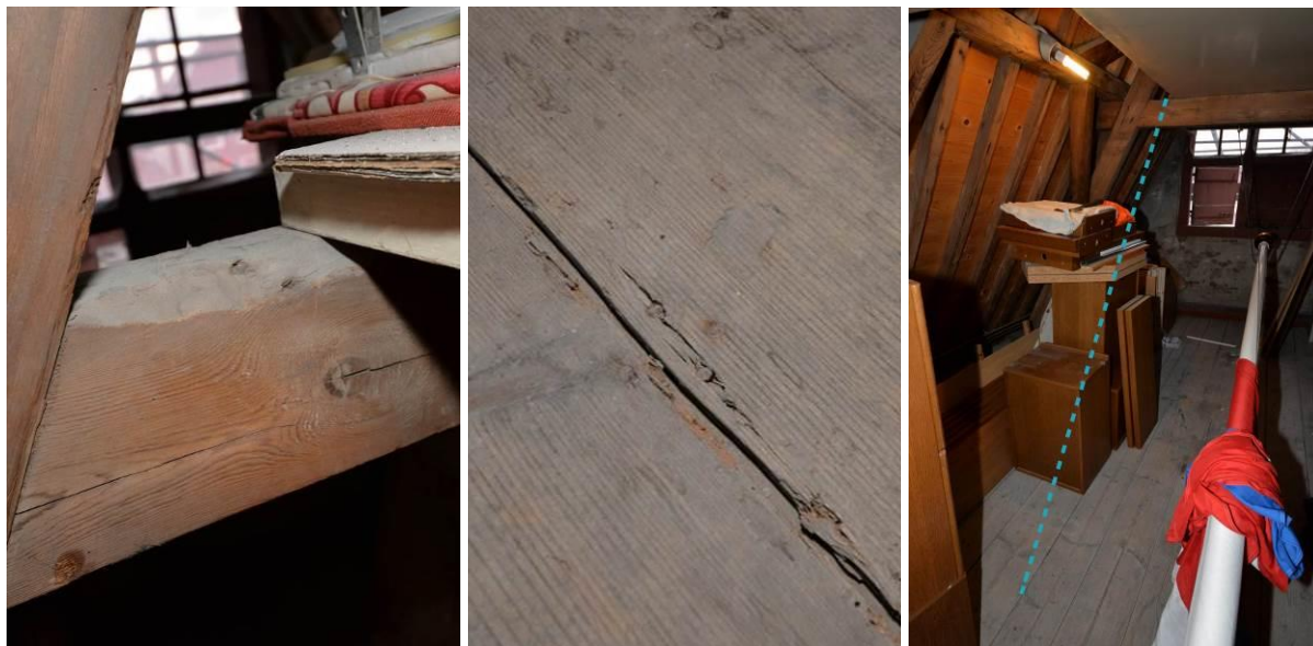
166 Rapenburg 29, 1664, nagelgaten in spantbalk van mogelijke tijdelijke afschoring (links)
