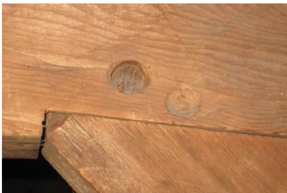
115 Fout geboord nagelgat, Rapenburg 67, 1623
