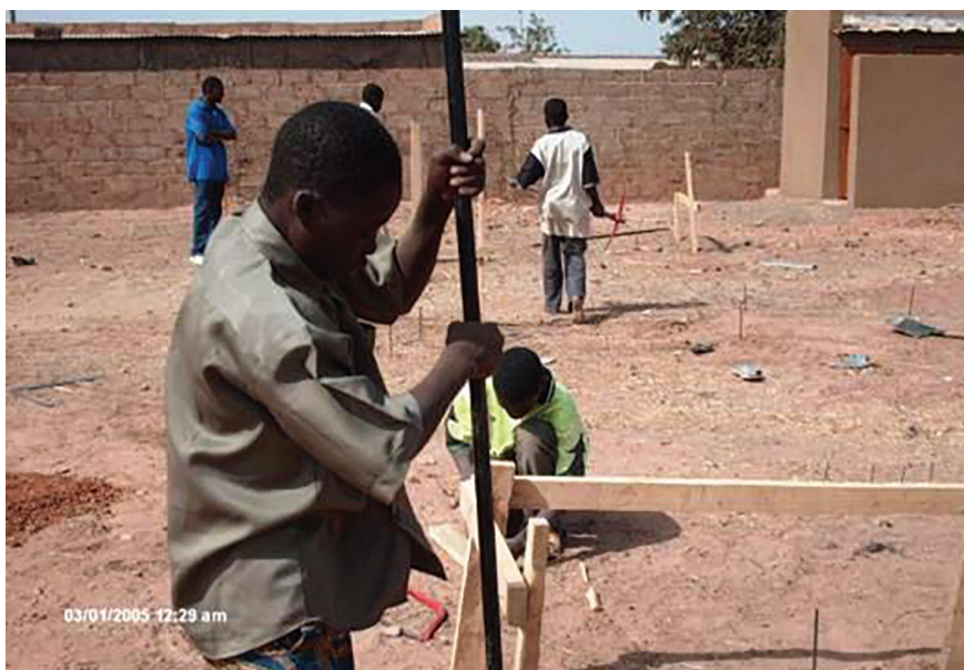
Figure 4 Quelques apprenants du centre-habitat de Kamboinsé , bénéficiaire de l'apprentissage en maçonnerie (Source: Yolande Lingané)
