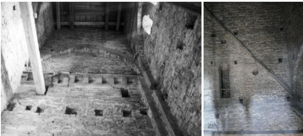
I.5.3.59A links: Mariatoren, reeks consoles als restant van een tijdelijke dakconstructie ter hoogte van het transeptdak, oostzijde (foto: JW).
