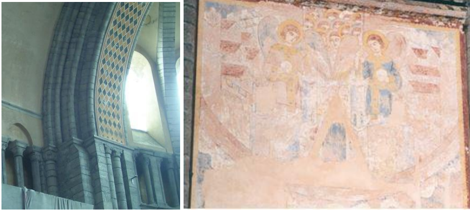
I.5.3.32A links: zuidelijke transeptarm, oostzijde, aanzet van de diafragma-boog die opent op de apsis (foto: JW). I.5.3.32B rechts: oostzijde van de travee tussen de transepttoeren, wandschildering met afbeelding van het Hemelse Jeruzalem (foto: KIK-IRPA).
