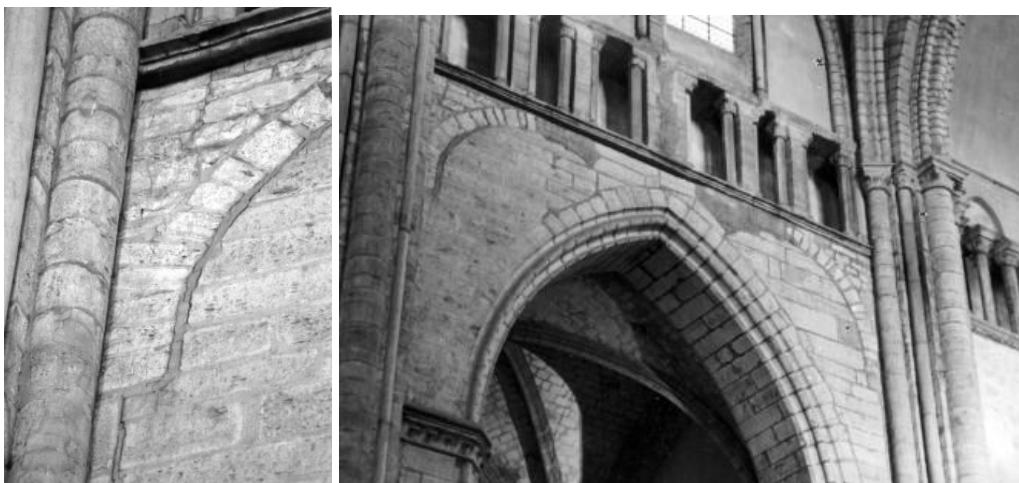
I.5.3.35A links: zuidelijke transeptarm, dubbeltravee, oostzijde, aanzet van boogprofiel in het metselwerk naast de vieringpijler (foto: JW).
