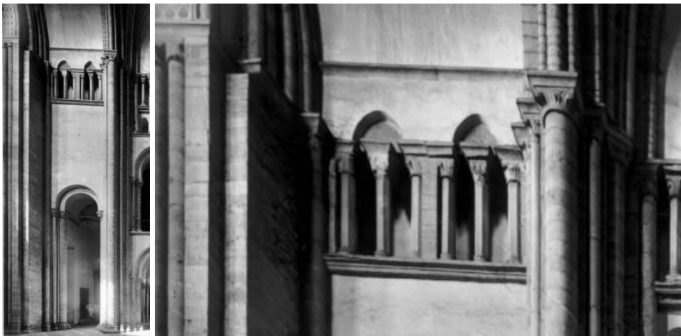
I.5.3.14A links: zuidelijke transeptarm, westzijde, opstand travee tussen de torens (foto: KIK-IRPA).
