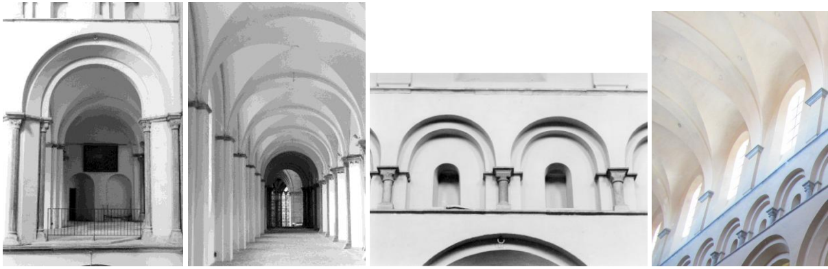
I.3.9A links: schip, noordzijde, laatste boog van de galerijarcade voor de viering (foto: JW).
