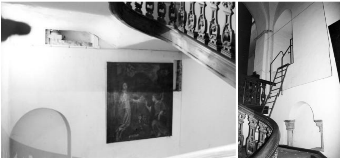
I.2.17A links: westpartij, trappenhuis in de noordelijke zijruimte, westwand met links onder de dichtgezette boogopening van de doorgang door de westmuur, rechts naast het schilderij een fragment van het begin van de wenteltrap in de noordwesthoek en boven de sokkel van de linker colonnet van de blinde rondboognis (foto: JW).
