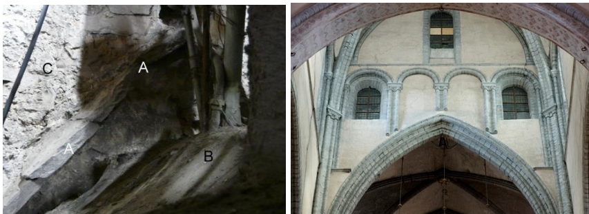
I.6.4A: detail van de dakmoet (A) van het 12de-eeuwse koor tegen de oostzijde van de vieringtoren (C) boven de gewelven van het 13de-eeuwse koor (B) (foto: JW).
