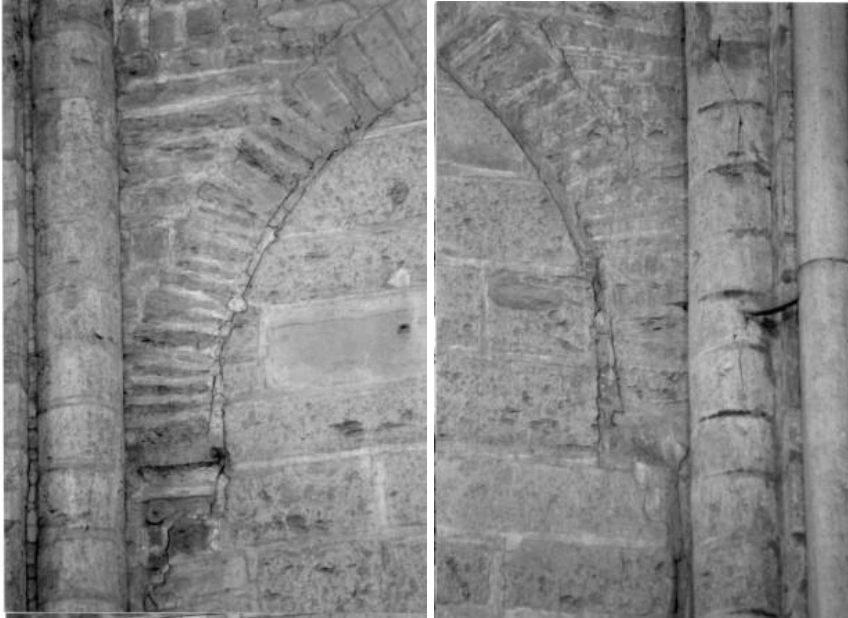
I.5.2.29A links: noordelijke transeptarm, oostwand, dubbeltravee, zwik van de spitsboog nabij de pijler van de Sint-Janstoren (foto: JW).
