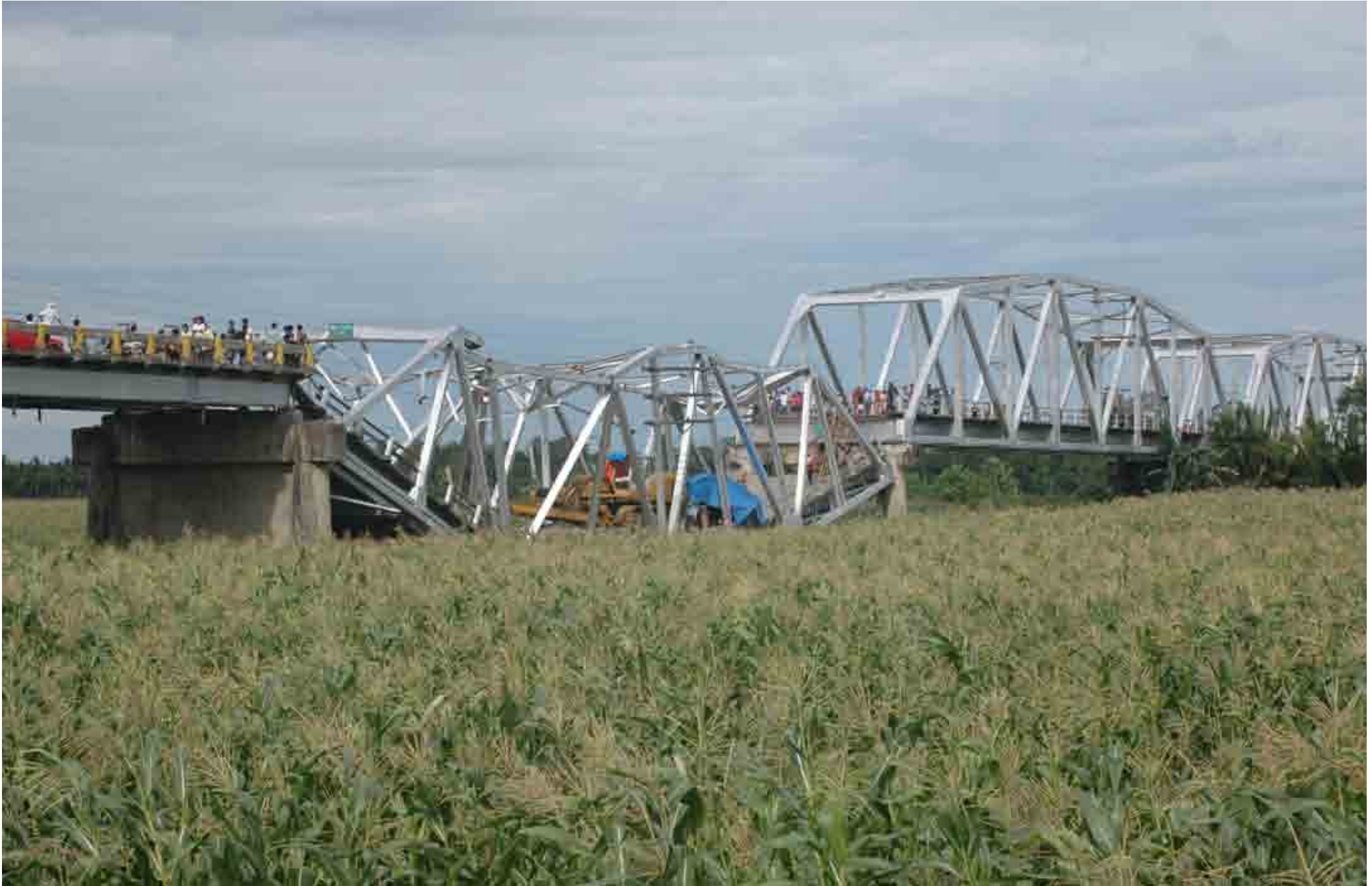
Collapsed bridge in Cagayan (van der Ploeg 2007)
