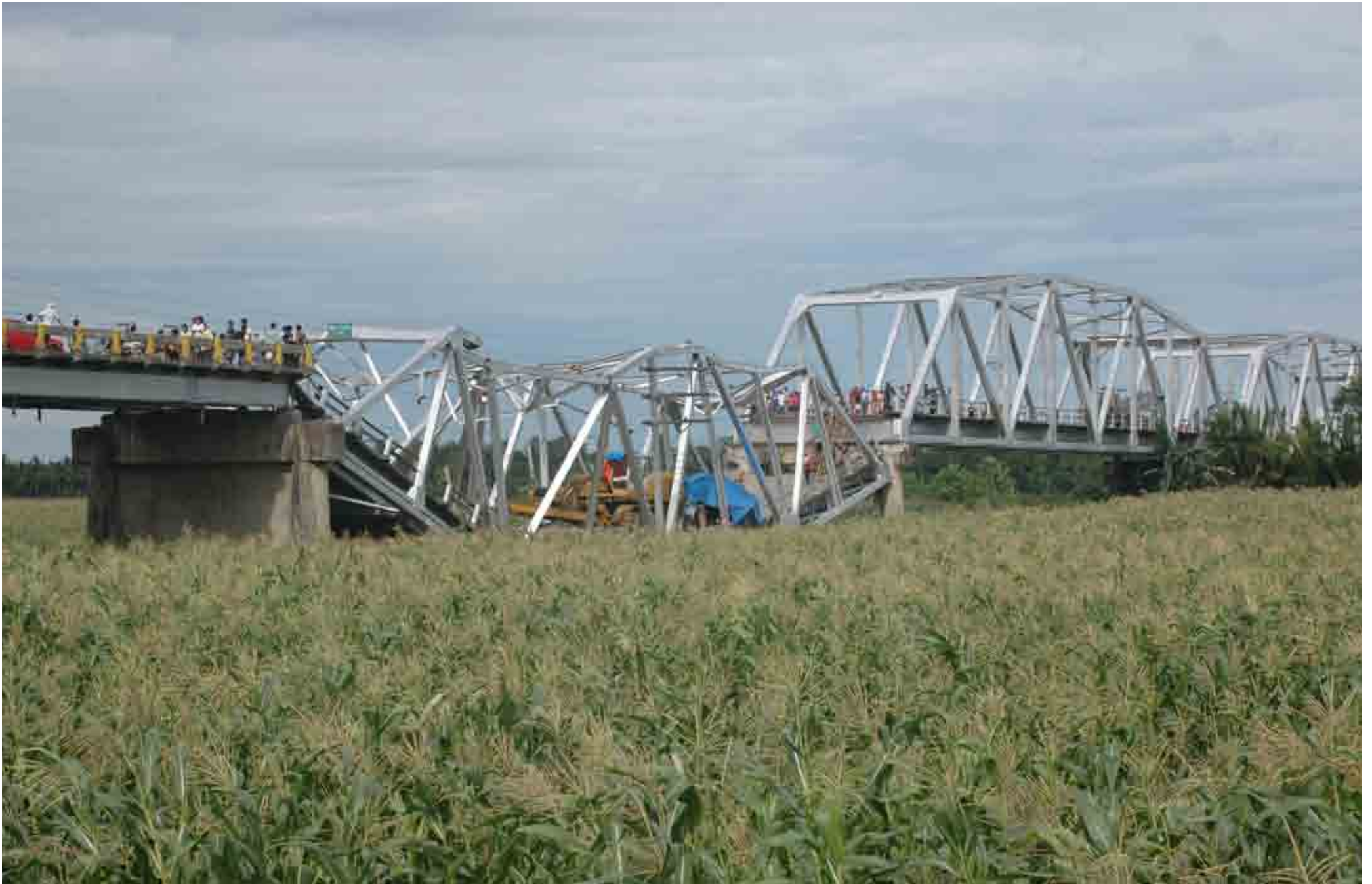
Collapsed bridge in Cagayan (van der Ploeg 2007)
