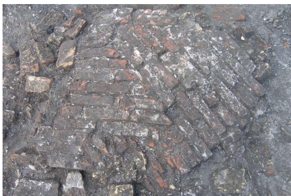
7-32 Detail van het omgetrokken muurwerk van bijgebouw 1. Het betreft een deel van een gevel met vlechtingen.
